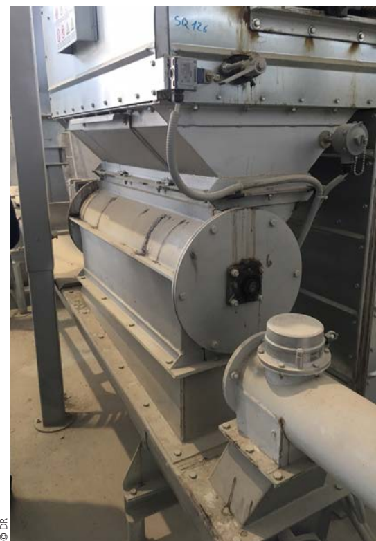
→ Vue arrière du toasteur avec l'écluse de sortie du produit toasté. On distingue la vis d'évacuation qui reprend également les sorties sous cyclones.
