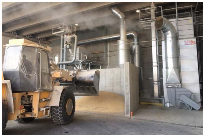
→ Le toasting de soja avant mise en stockage. Le soja est déposé dans une fosse de réception dédiée qui constitue la réserve amont d'alimentation et de régulation du toasteur.
